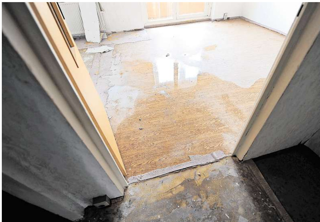
Wasserschaden in der Wohnung? Mieterinnen und Mieter sollten sich jetzt umgehend an ihren Vermieter wenden.
