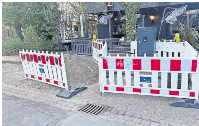
Die E-Ladesäule an der Eichstraße in Krähenwinkel steht seit Ostern. Foto: Oliver Krebs
