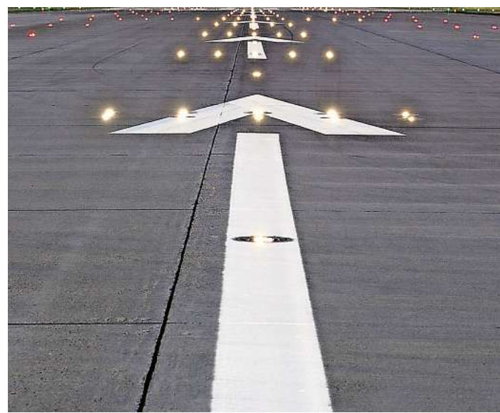
Die Nordbahn ist gesperrt.
