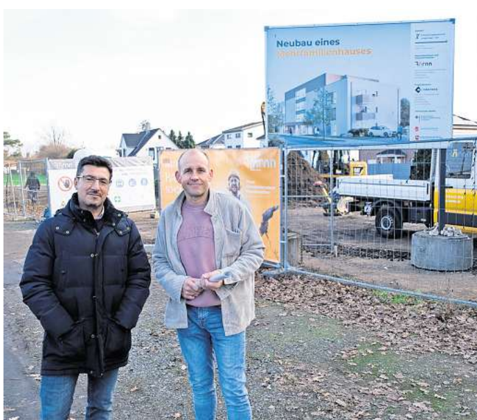
Besichtigen die Baustelle in Godshorn, auf der vor ein paar Tagen der Bau des Mehrfamilienhauses begonnen hat: Abdulselam Selcuk, Architekt der bauausführenden Firma BöCon (links), und Lars Hecht, Geschäftsführer der Entwicklungsgesellschaft Langenhagen.
