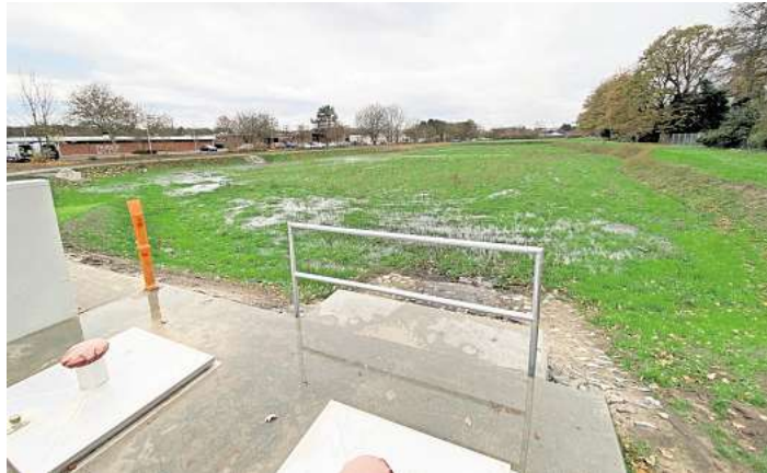
Fertiggestellt: Das Regenrückhaltebecken speichert bei Starkregen das Wasser und entlastet die Kanalisation. Foto: Katerina Jarolim-Vormeier
