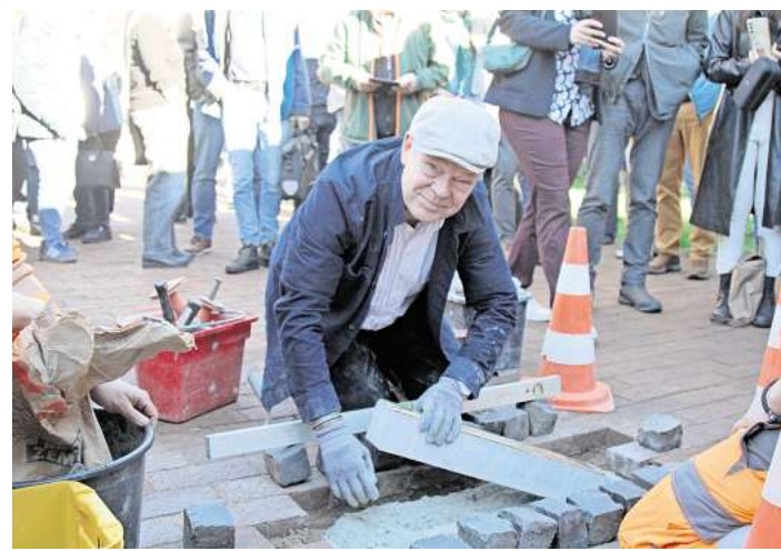
Bei der Arbeit: Frank-Matthias Mann verbaut die Stolperschwelle in den Boden. Foto: Stephan Hartung
