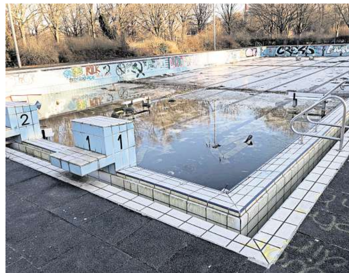
Schandfleck: Das seit Jahren geschlossenen ehemalige Hallen-Freibad Godshorn ist zu einer Müllippe heruntergekommen.
