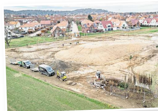
In einem Baugebiet in Gerhden hat das Langenhagener Unternehmen die Außenanlagen angelegt. Foto: Mats Schmidt
