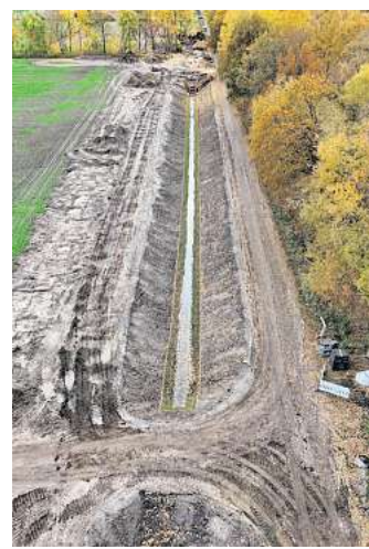
Umbau des Entwässerungssystems Kaltenweider Hauptvorfluter außerhalb der Moorflächen für die angrenzenden Nutzflächen am Achtminutenweg in Langenhagen. Foto: Johanna Franz
