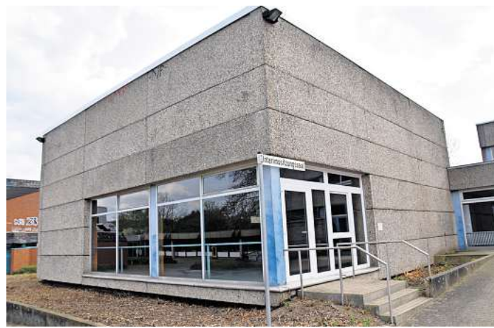
Die Vergangenheit: Die kleine Sporthalle an der IGS Langenhagen wird bald abgerissen. Foto: Gerko Naumann
