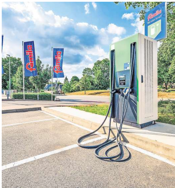
In Langenhagen kommen in diesem Jahr E-Ladesäulen an die Hans-Böckler-Straße zu familia. Foto: Henrik Matzen
