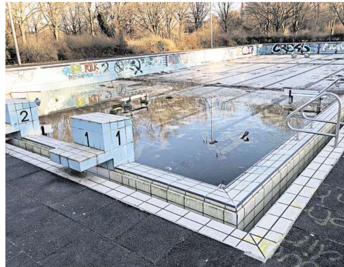
Schandfleck: Das seit Jahren geschlossenen ehemalige Hallen-Freibad Godshorn ist zu einer Müllippe heruntergekommen.
